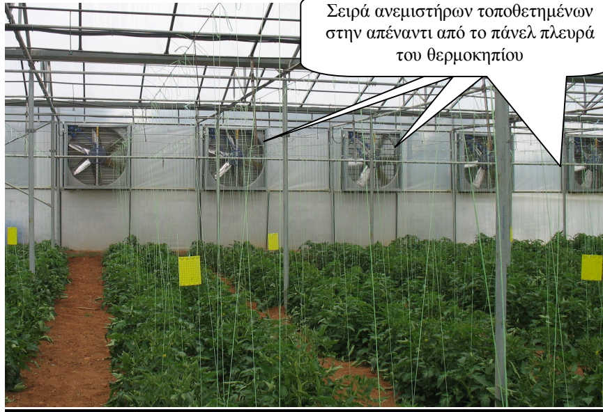
Σύστημα δροσισμού με πάνελ.
