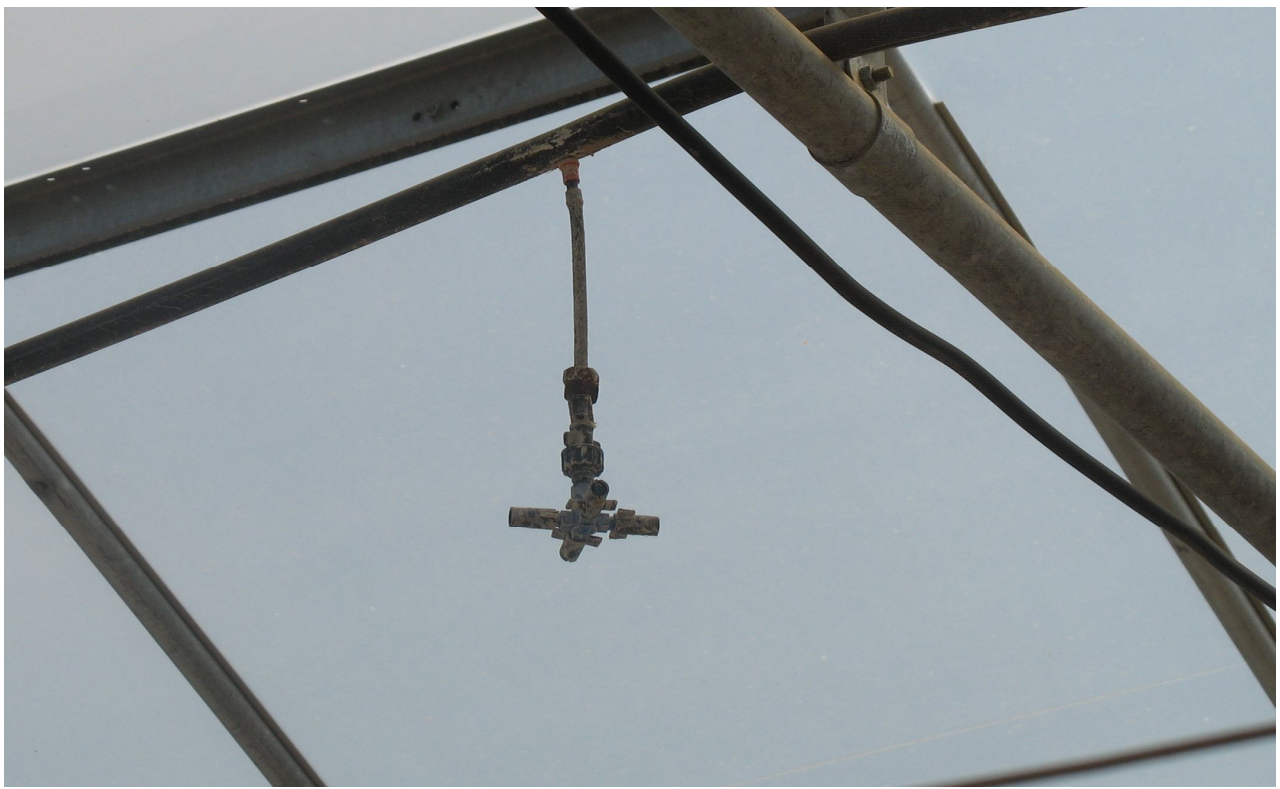
Σύστημα fogger (διακρίνονται τα άλατα που έχουν συσσωρευτεί πάνω στον εκτοξευτήρα)
