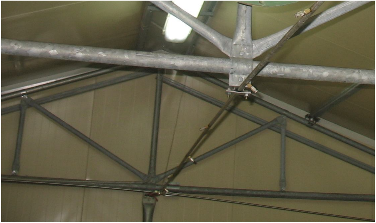
Σύστημα fog – διακρίνεται ο μεταλλικός σωλήνας μεταφοράς νερού και τα μεταλλικά ακροφύσια.
