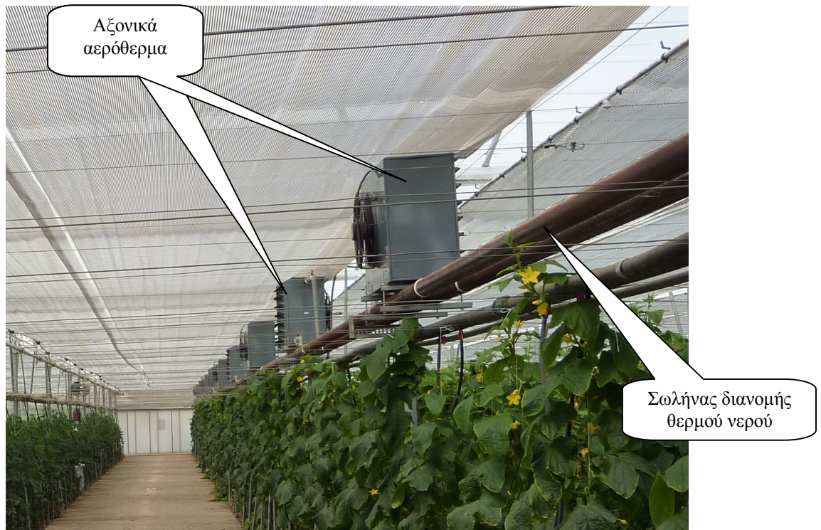
Σύστημα θέρμανσης με την κυκλοφορία ζεστού νερού και αξονικά αερόθερμα.
